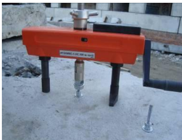
Рис. 1. Вырыв анкера Омах 8-45 М6 из бетонного основания
