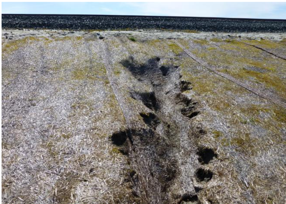
Рис. 1. Пример деформационных процессов земляного полотна ПК 14651+70
