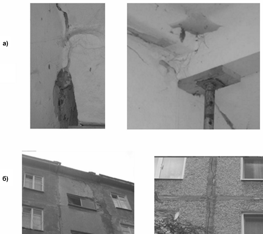
Рис. 1. Раскрытие деформационных швов и стыков между панелями: а – узел опирания лестничного марша; б – трещины в швах наружных панелей
