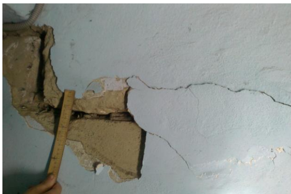
Рис. 8. Трещина справа от входа в здание
