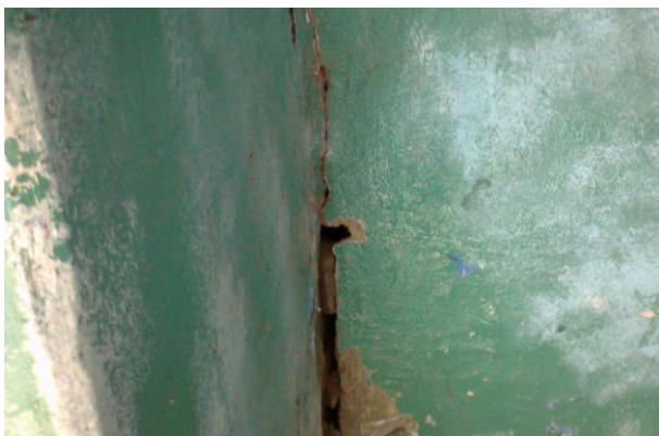
Рис. 7. Трещина в тамбуре, слева, на стыке наружной и внутренней стен
