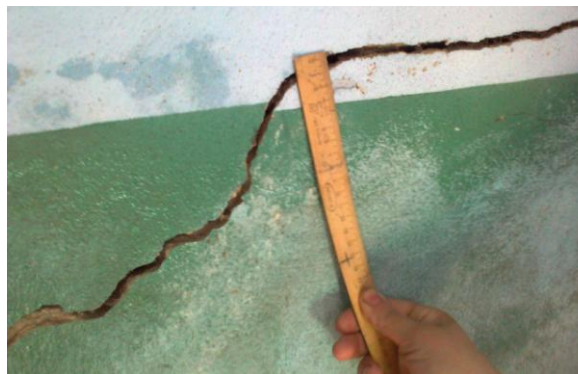
Рис. 9. Сквозная трещина на внутренней стене, разделяющей тамбур и квартиру № 1
