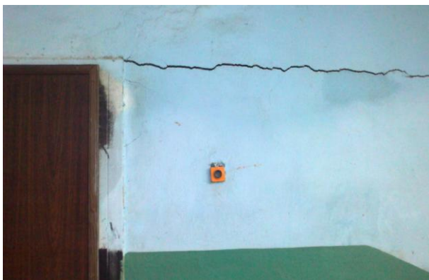
Рис. 5. Трещина справа от квартиры № 4
