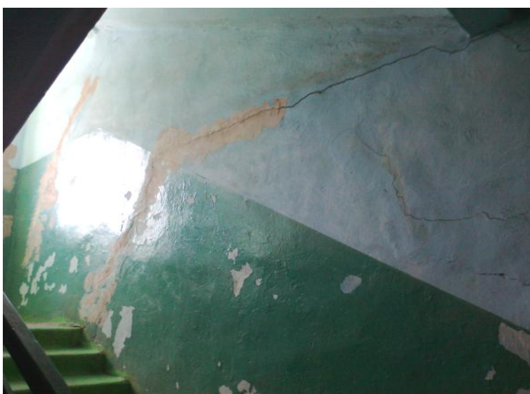
Рис. 4. Трещины вдоль лестничного марша слева от квартиры № 1
