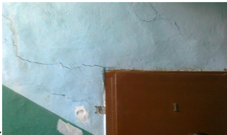
Рис. 3. Трещины слева и выше входной двери квартиры № 1
