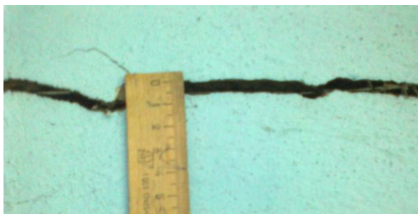
Рис. 6. Ширина трещины справа от квартиры № 4
