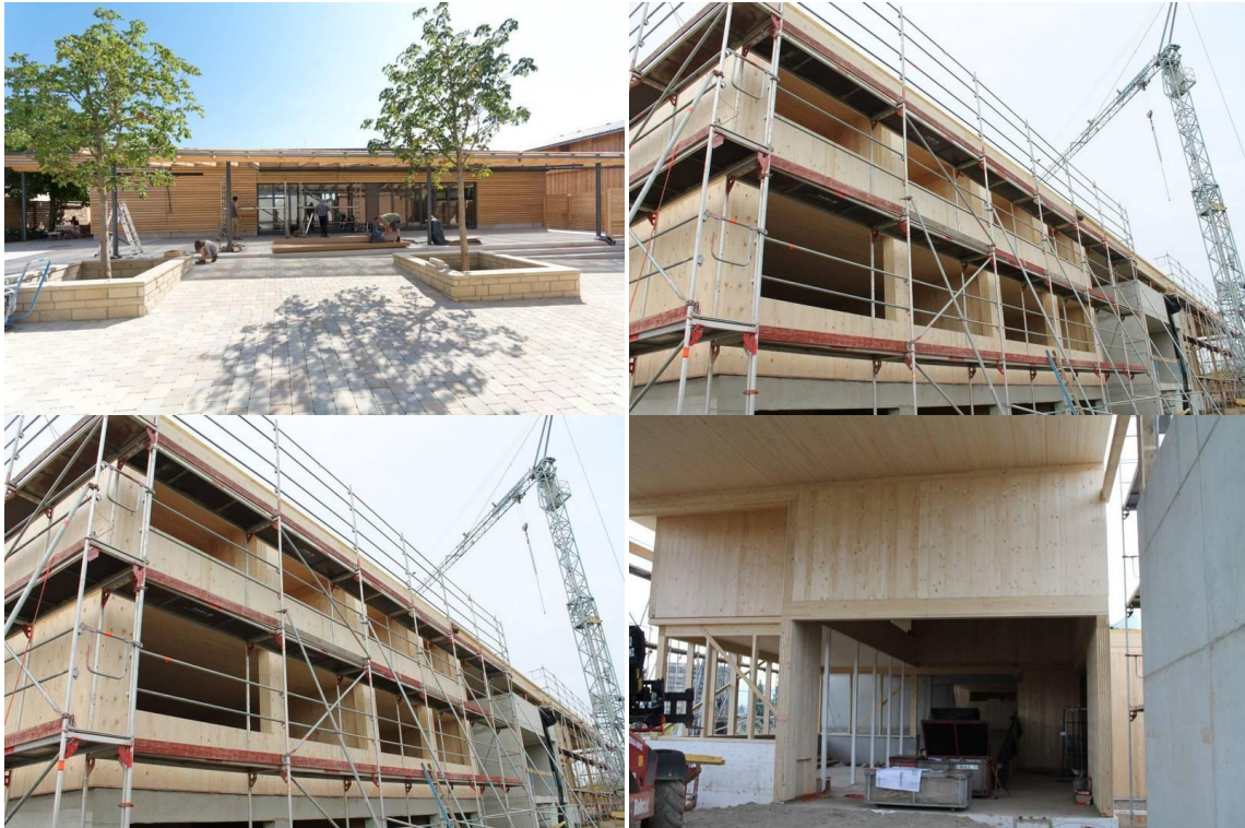
Рис. 2. Винодельческий завод. Йоханеса Б., возведенный по технологии Massiv-Holz-Mauer, арх. Dengler Katzenwald Zischler Architekten, Фелльбах
