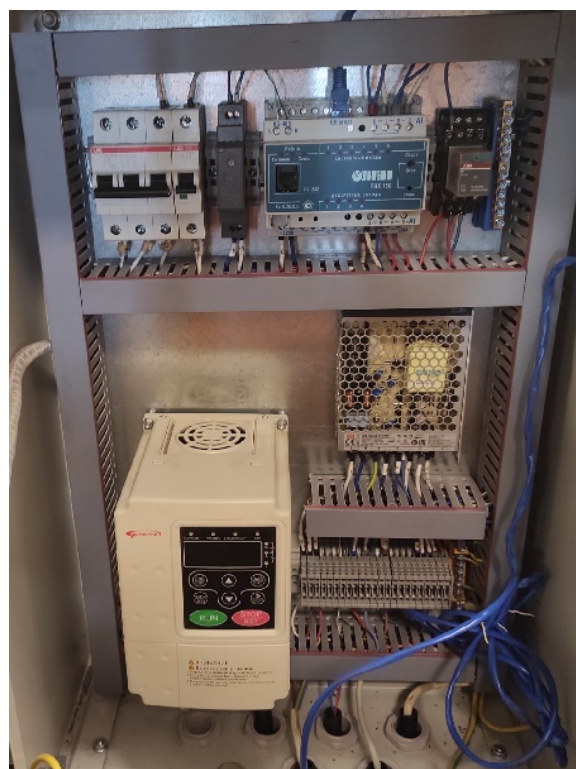
Рис. 3. Фото шкафа управления лабораторного стенда Fig. 3. Photo of the control cabinet of the laboratory stand
