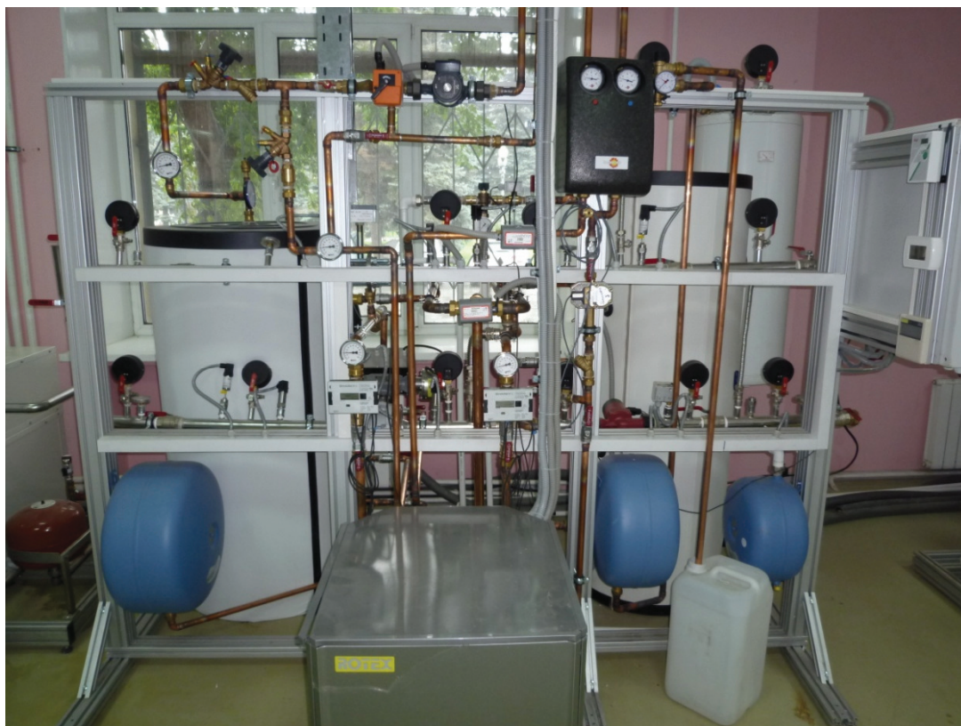
Рис. 1. Общий вид стенда моделирования гибридных систем теплоснабжения
