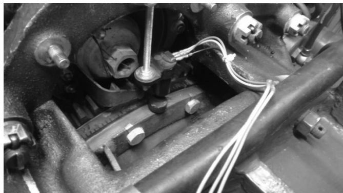
Рис. 7. Установка датчика Холла в дизель-генераторе 1Д20
