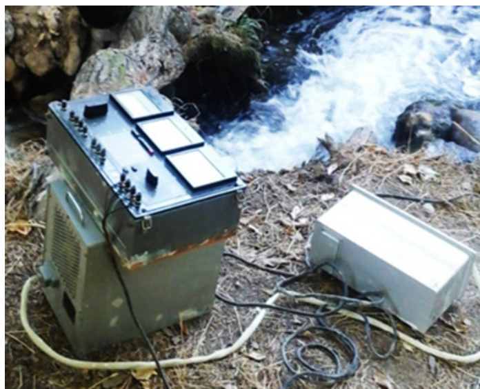
Рис. 8. Внешний вид накопителя электроэнергии Fig. 8. Appearance of the energy storage
