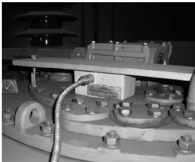
Рис. 4. Расположение комплексного датчика на крышке РПН трансформатора
