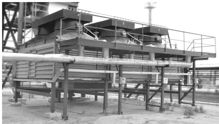
Рис. 1. Трехсекционный АВОм ГТН-16
