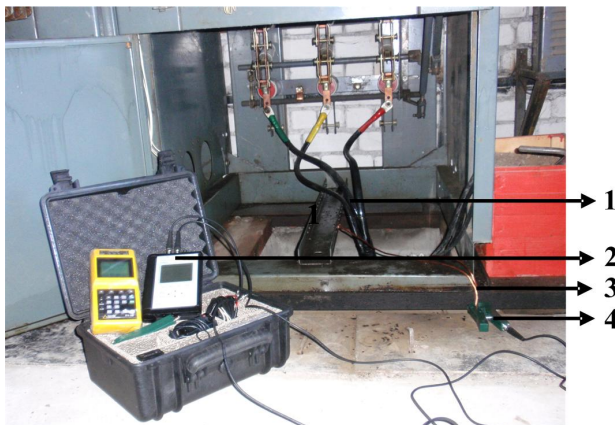
Рис. 1. Экспериментальные исследования в ячейке ввода КЛ в ТП: 1 – КЛ; 2 – устройство по оценке параметров ЧР; 3 – заземляющий проводник КЛ; 4 – высокочастотный датчик ЧР RFCT-5
